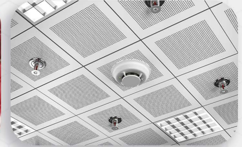
مرشات الحريق FIRE SPRINKLERS
